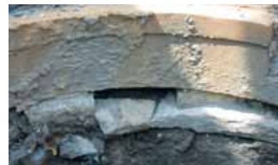
Častý obraz poškodenia maltovej špáry.
